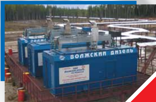
Томская обл., Линейное м.р., Газопоршневой энергокомплекс ГДГ90 (3x500 кВт).
