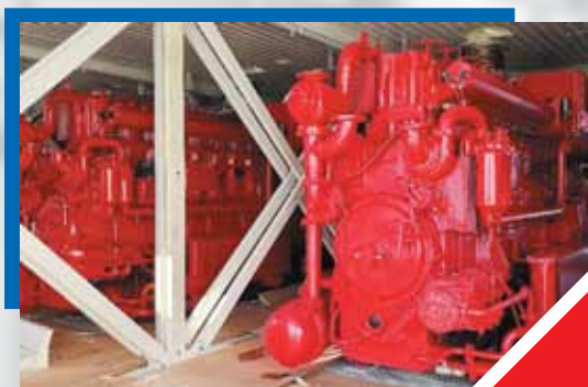
Высоковольтный дизельный энергокомплекс мощностью 6 МВт. Резервное энергоснабжение инфраструктуры города в Архангельской обл.
