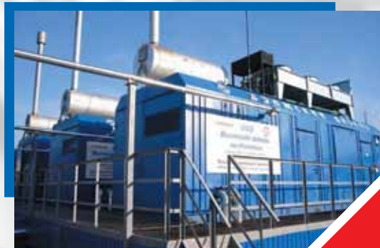
Газопоршневой энергокомплекс и ДЭС для «ТОМСКГАЗПРОМ» суммарной мощностью 2 МВт.
