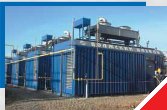
Энергокомплекс мощностью 3 МВт на природном газе с СУОТ для стекольного завода в Ростовской области.
