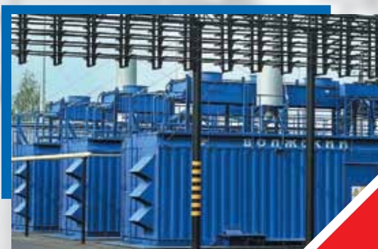
Саранск. Газопоршневой энергокомплекс для производственных цехов кабельного завода. ГЭ30 (0,4 кв, 800 кВт)/ ГЭ10У (0,4 кв, 500 кВт).
