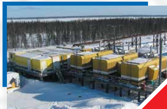
Высоковольтный дизельный энергокомплекс мощностью 3 МВт для жилого поселка.
